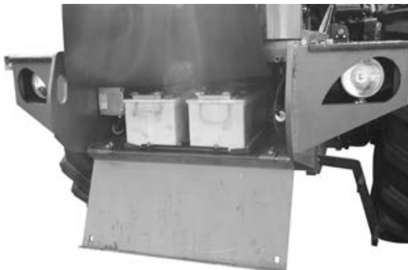
Рисунок 2.77 — Расположение аккумуляторных батарей
